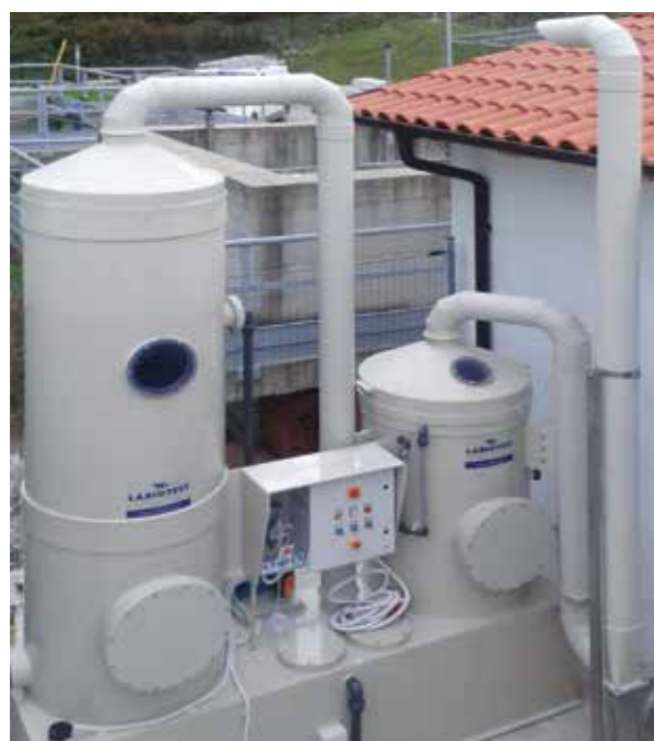
DkFil® + Scrubber applicato a impianto di trattamento acque reflue
