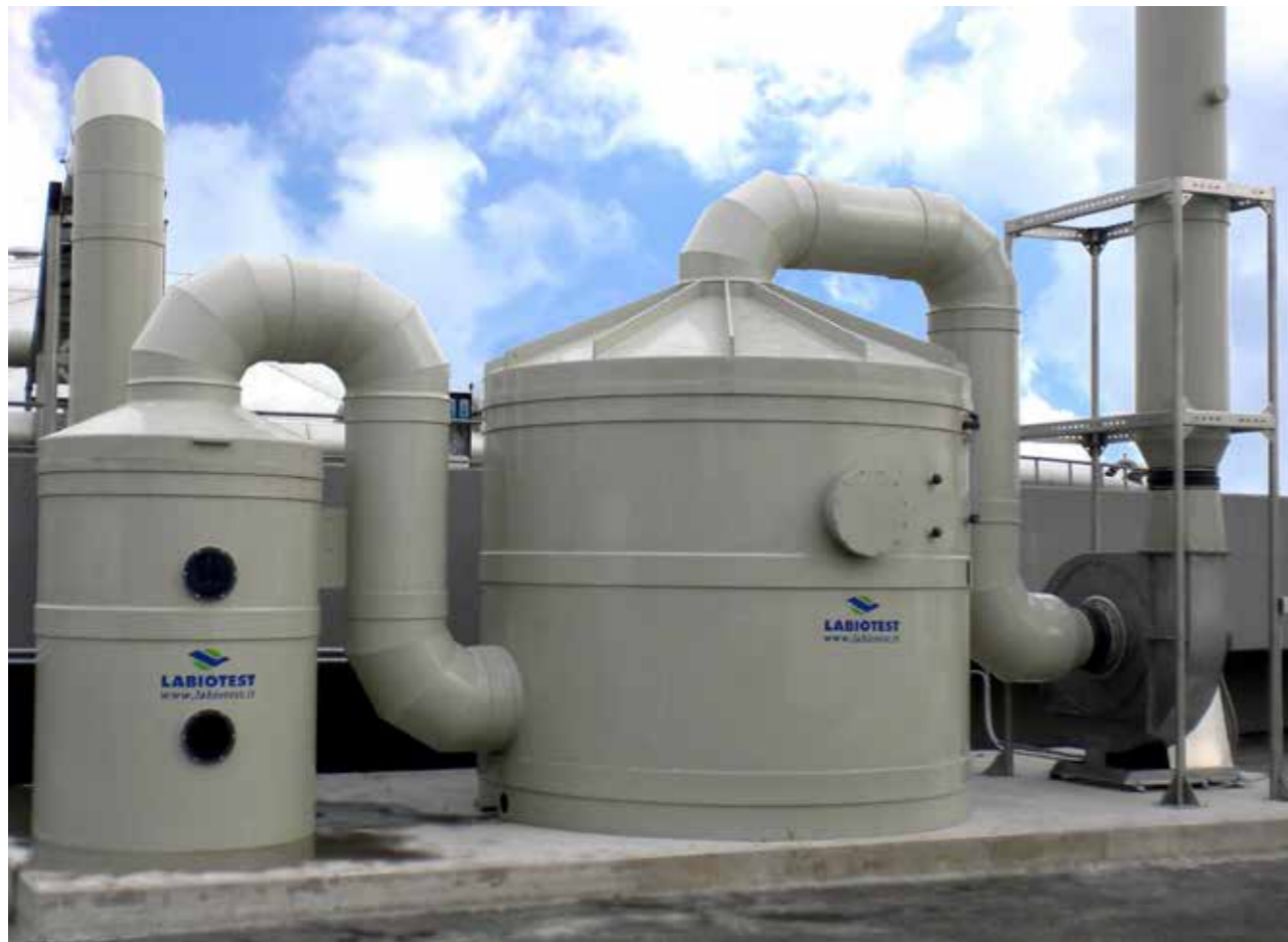
DKFil® 14.000 Nm 3 /h applicato a impianto di trattamento acque reflue
