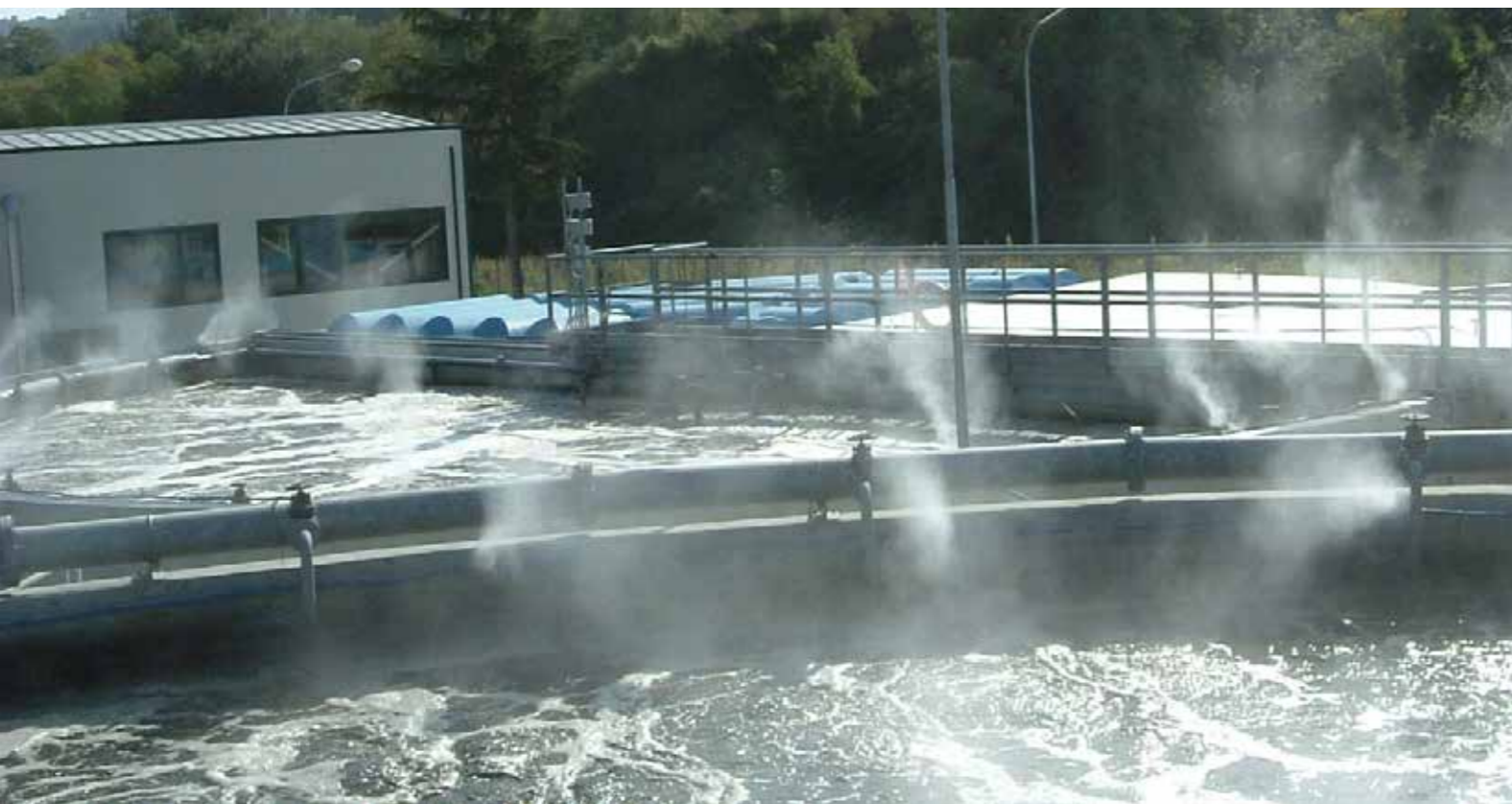
Emissione diffusa outdoor - Trattamento acque reflue 250 ugelli
