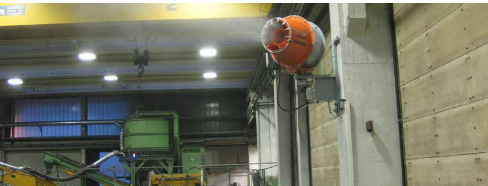
Emissione diffusa indoor impianto trattamento rifiuti - Big Fogger Plus fisso
