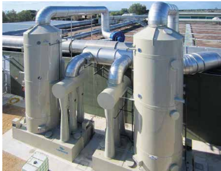
2 Scrubber da 50.000 Nm 3 /h
